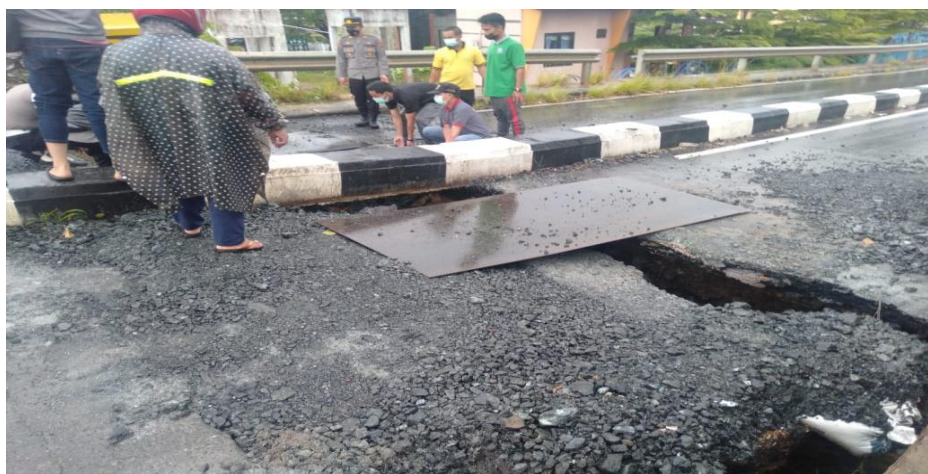
Gambar, penanganan sementara Oleh Tim Kecamatan Takisung jembatan yg terputus bias di lewati, (Jembatan Pantai Takisung penghubung Objek Wisata dan dua desa yaitu Ds. Pagatan dan Ds. Tabanio.
