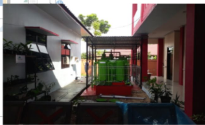
Instalasi Pengolahan Air Limbah 100 %
